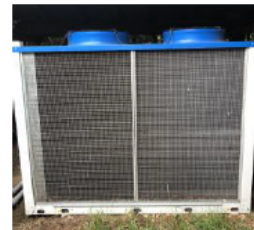
Pompa di calore
