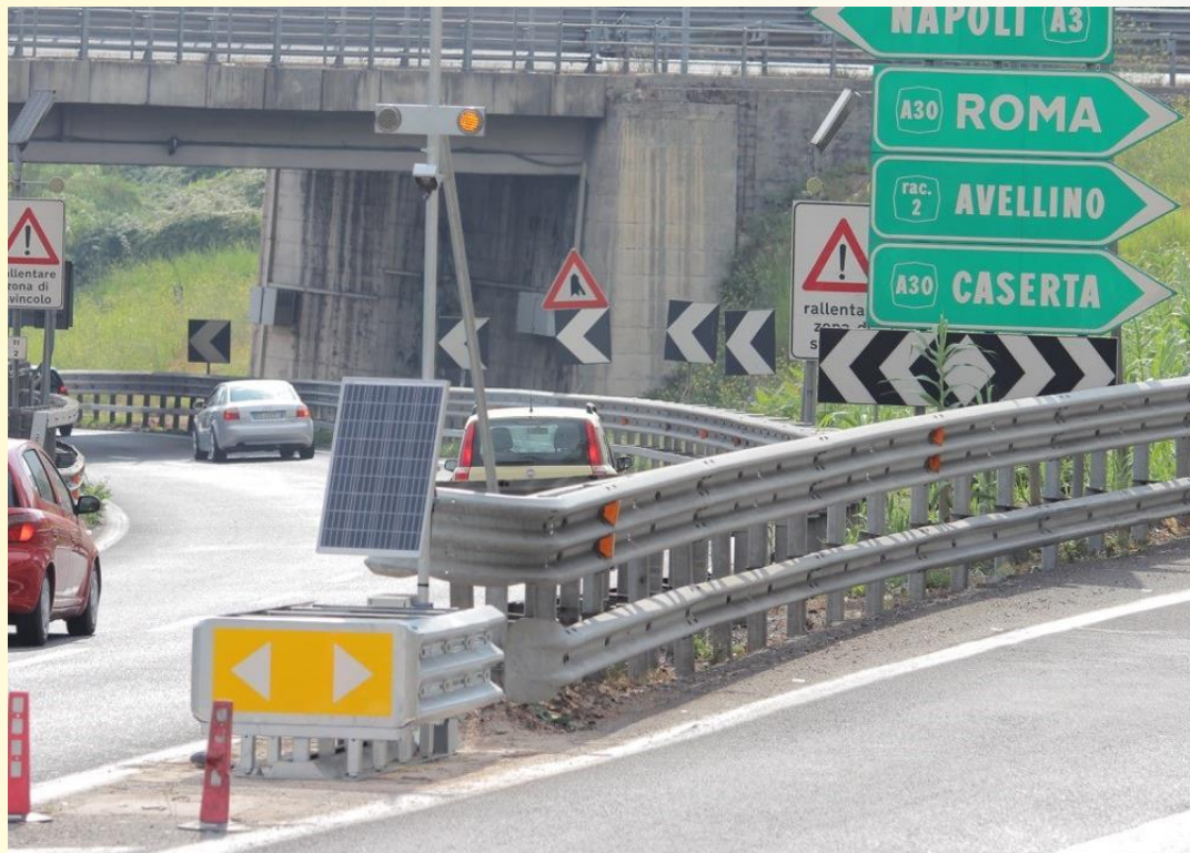
Esempio di installazione di Geronimo a Fratte (SA). Il palo è fissato su una base in cemento armato
