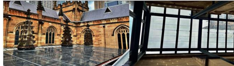
Cattedrale di Saint Andrew- Sydney, Australia (AU). Installazione moduli in vetro fotovoltaico al silicio amorfo a basso grado di trasparenza. Fonte Bipv meets history
