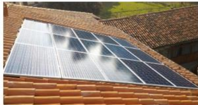
Impianto fotovoltaico integrato in copertura Appiano Gentile (MI). Fonte Wolmann
