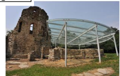
Copertura del Battistero di San Giovanni, Parco Archeologico di Castelseprio (VA). Fonte Unisi
