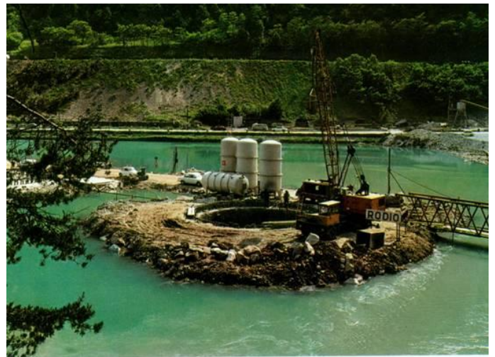
Congelamento per un viadotto sul Lago di Fortezza Autostrada del Brennero, 1970/71 - Impresa RODIO
