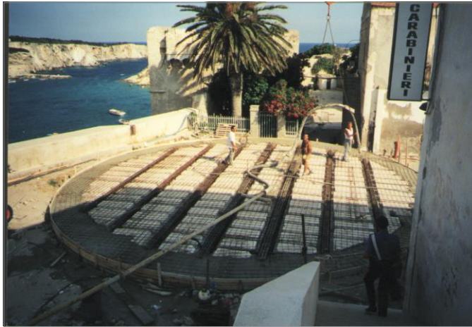
La struttura di copertura del pozzo realizzata in travi REP (travi miste acciaio-calcestruzzo) sulla quale verrà poi ripristinata la pavimentazione della piazza.
