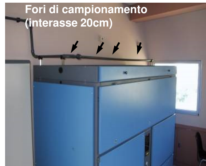
Dettaglio della tubazione
