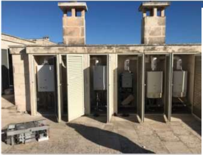
Caldai esistenti da sostituire
