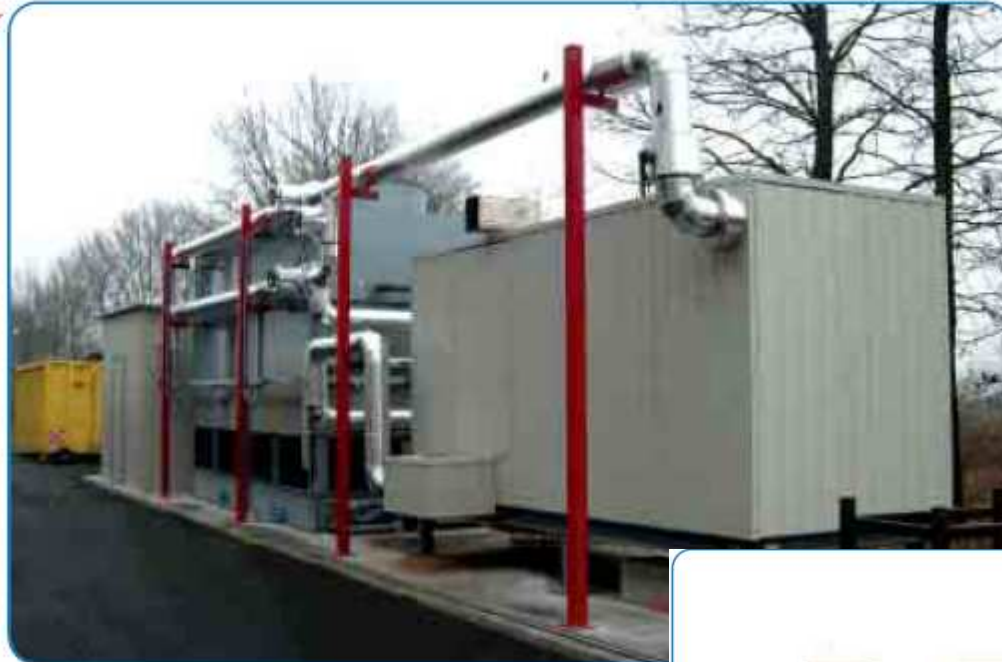
Impianto ad assorbimento in pompa di calore 582kW
