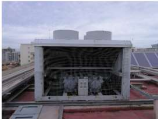
Pompe di calore Carrier 30GH045 da 124 kW/ciascuna
