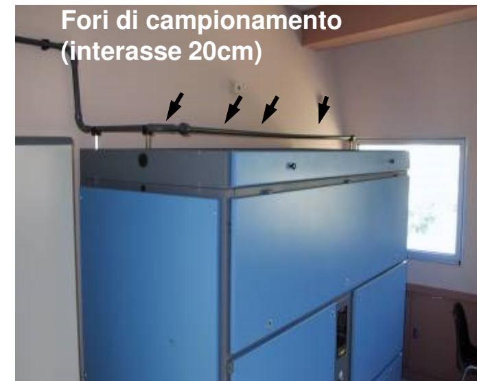
Dettaglio della tubazione
