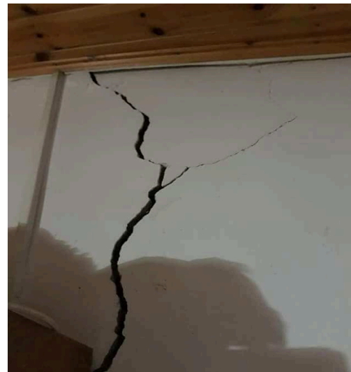
FESSURE SU DIVISORI
