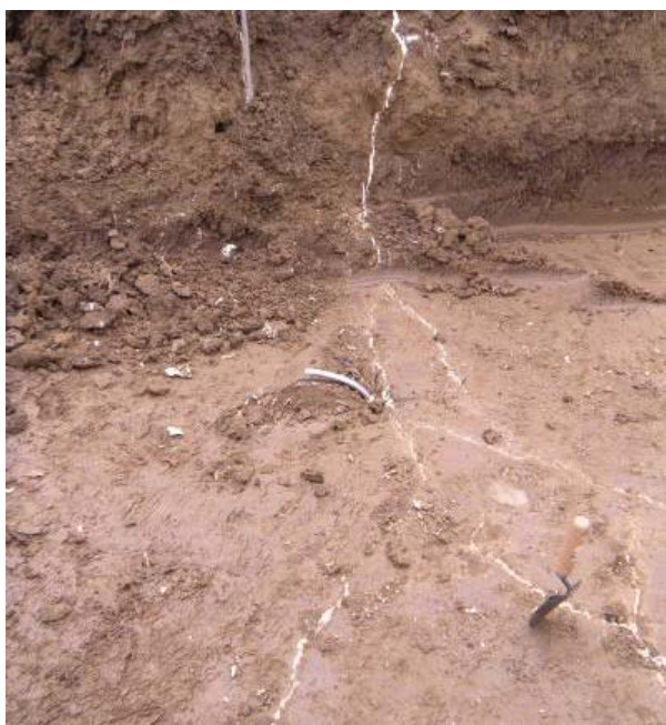
Figura 26 – Lo scavo a giorno a messo in evidenza i percorsi della resina nel terreno consolidato e fratturazioni indotte con propagazione sul piano orizzontale.
