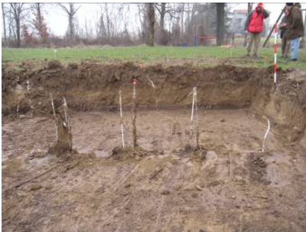
Figura 11 – Lo scavo a giorno del test site post iniezioni, si osservano i terminali dei piccoli tubi di iniezione della resina che fuoriescono dal terreno.
