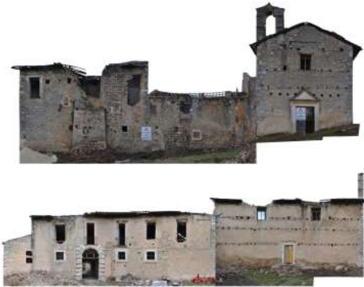
Caso Studio: Convento di Santa Maria delle Grazie - L'Aquila Progetto e DL: Ing. Andrea Giannantoni Impresa: Tecnoclima Group Srl - AQ
