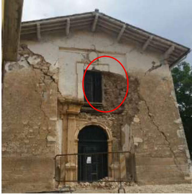
Sisma del 24 agosto 2016: danni in una chiesa a Norcia
