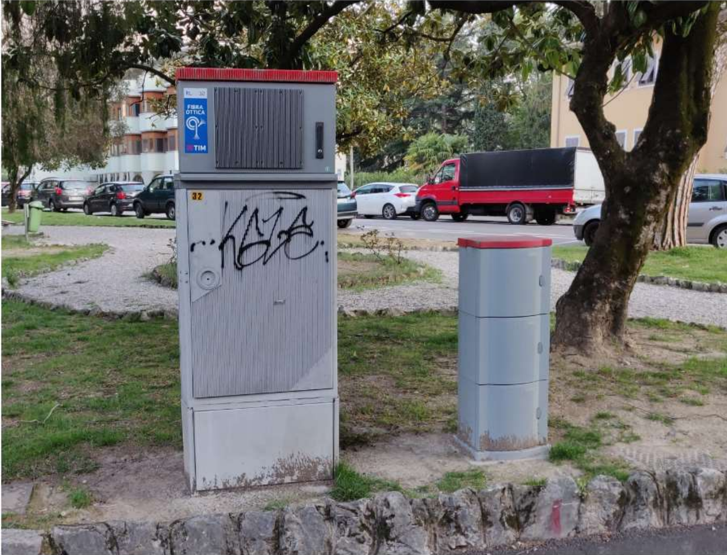
Armadio TIM (a sinistra) con soprizzo ONU-DSLAM (sopra). A destra, la colonnina di alimentazione contenente un trasformatore e un contatore Enel.
